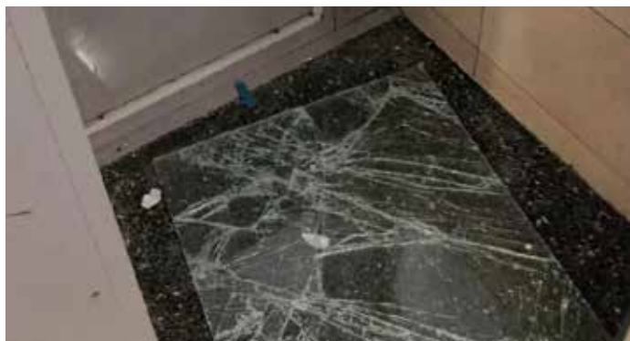
DÉGRADATIONS DANS UN IMMEUBLE
