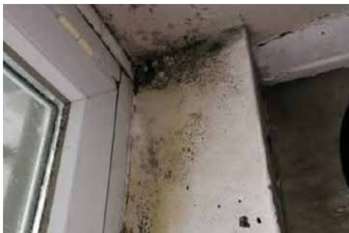
UNE SITUATION DE LOGEMENT DÉGRADÉ
