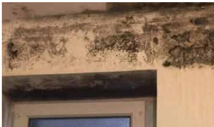
LES TRACES D'HUMIDITÉ
